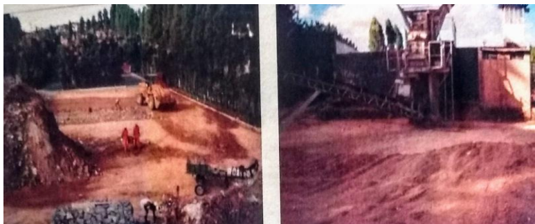
Figura 10: Usina de reciclagem de RCD em Pampulha, Belo Horizonte, MG
