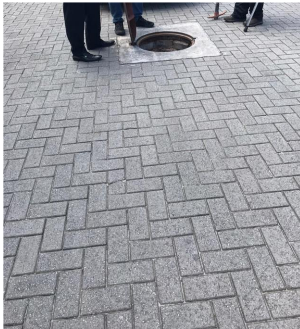
Figura 2 - Pavimento sem subsidência em torno do PV (Praia da Baleia)
