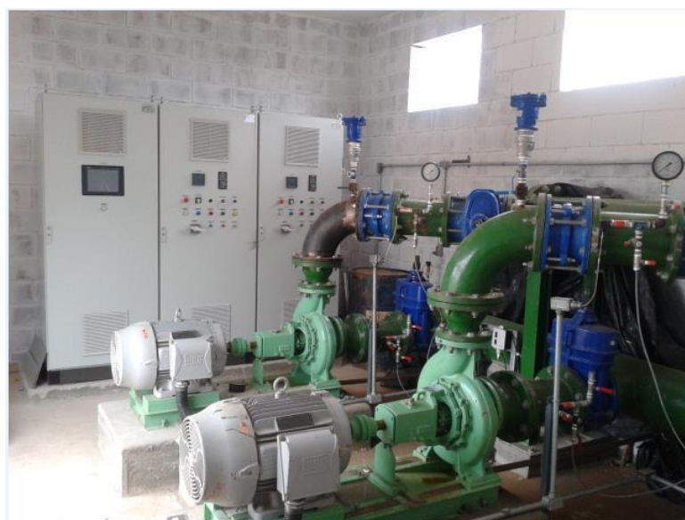
Figura 3 – Booster instalado em Shangrilá (Grajaú) com painel de comando
